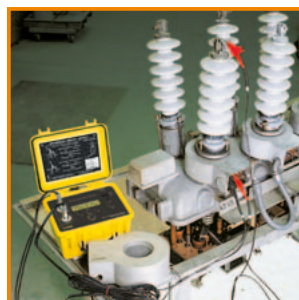
Mesure du rapport d'un transformateur de courant
