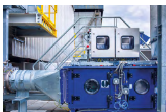
Régulation de la pression dynamique / psychrométrie / température / débit d'air / TRA* dans les centrales de traitement d'air et les gaines
